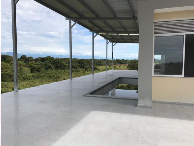
Foto 4: Edificio Aulas Cuarto Piso (Foto agosto 2017)
